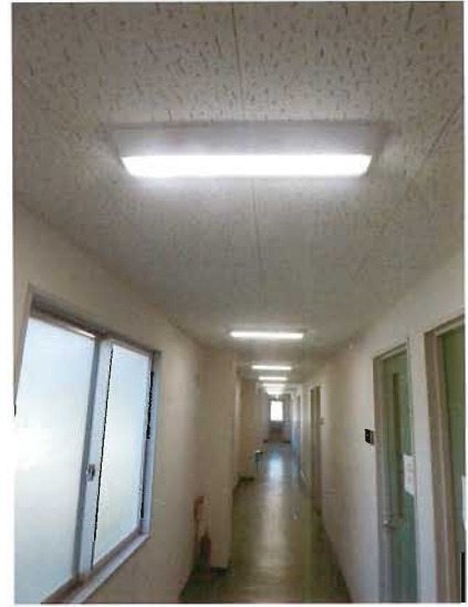
クラブハウスLED照明
